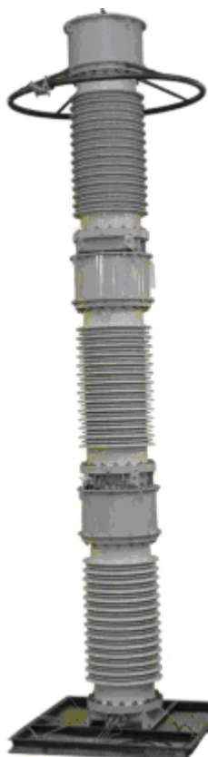
Трансформатор напряжения НАМИ-330
